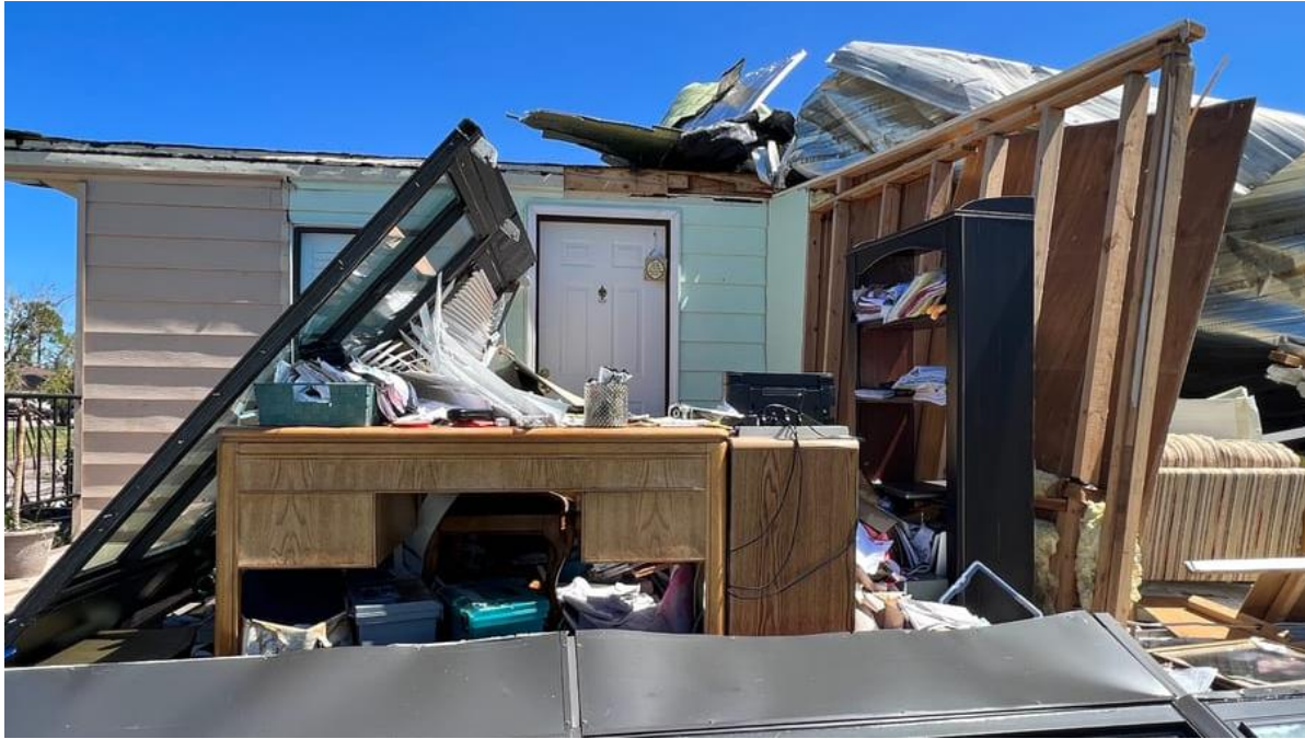
Imagen 1-2. Daños del huracán Ian en el condado de Sarasota 3
