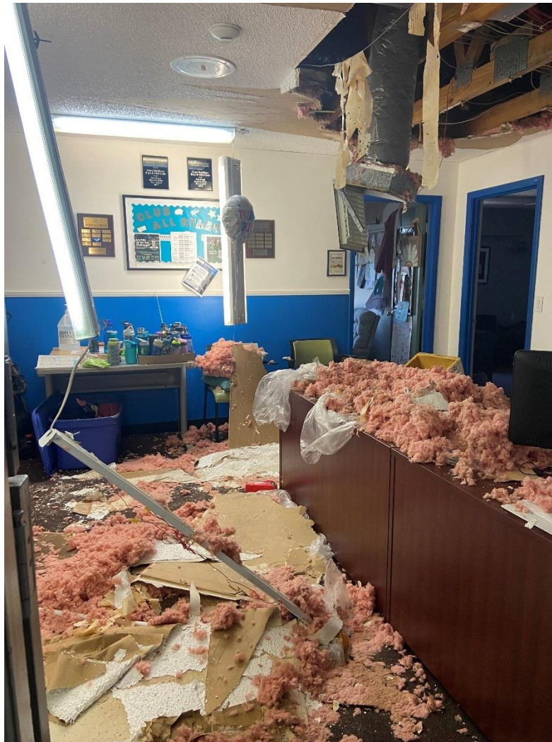
Imagen 1-6. Daños causados por el huracán Ian en el interior del Boys & Girls Club de la ciudad de North Port 7
